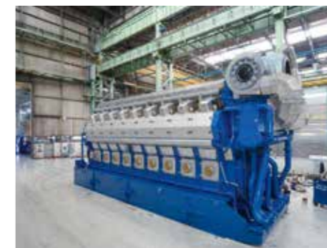
Imágenes de izquierda a derecha: Central eléctrica, Texas; DF Motor Wartsila
