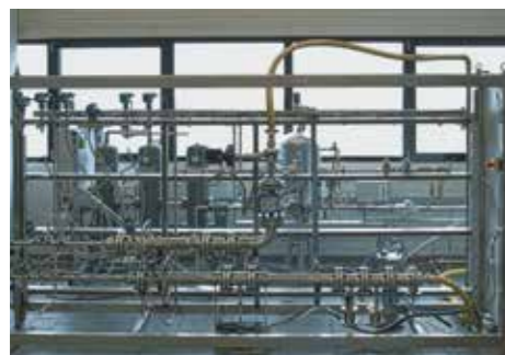
Banco de pruebas de gas BOLL & KIRCH
